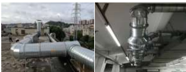
廢氣收集管道
