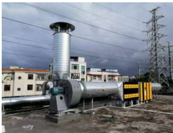
紫外線光解及活性炭吸附設備
